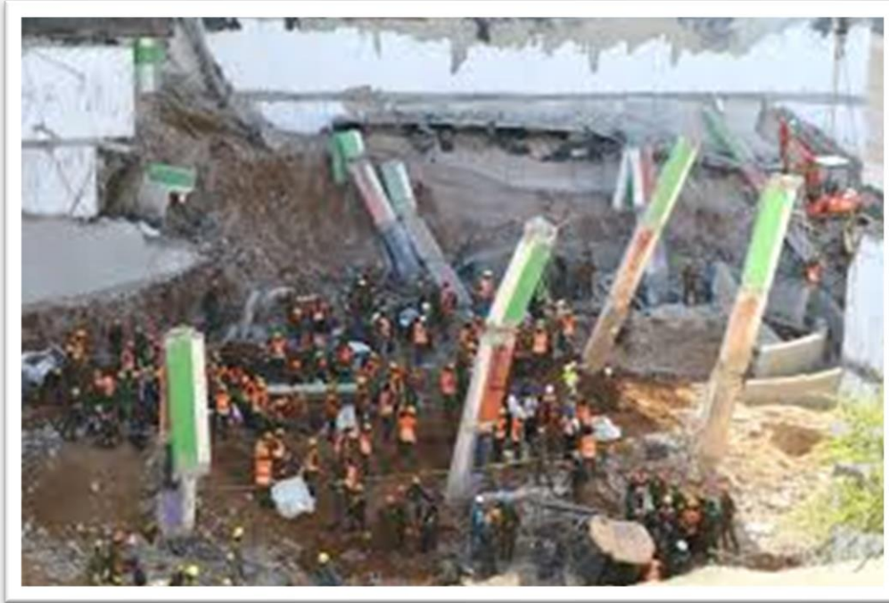
קריסת תקרה בחניון הברזל בת"א
